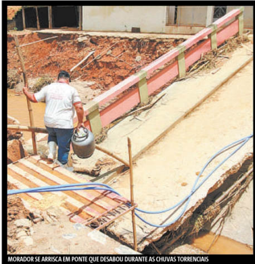
MORADOR SE ARRISCA EM PONTE QUE DESABOU DURANTE AS CHUVAS TORRENCIAIS
