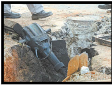
MARCAS DO FOGO NO LOCAL: PROVÁVEL CAUSA FOI PERFURAÇÃO DE CABOS
