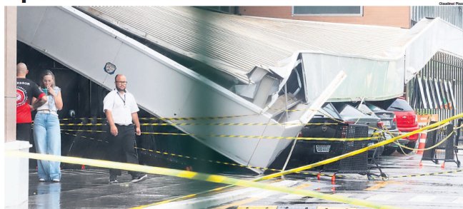
ESTRAGO. Marquise do supermercado Sonda, no bairro Barcelona, em S.Caetano, caiu sobre carros estacionados por causa de tempestade. Árvores também foram ao chão
