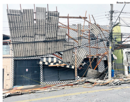
VENTANIA. Casa foi destelhada na Rua Eng. Armando de Arruda Pereira
