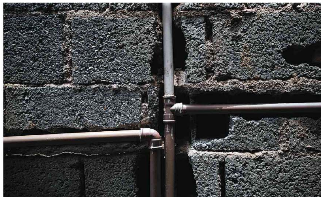
Tubulação de água em casa na Vila Aimoré, bairro na zona leste de São Paulo com problemas de saneamento. Zanonne Fraissat - 16.nov.23/Folhapress
