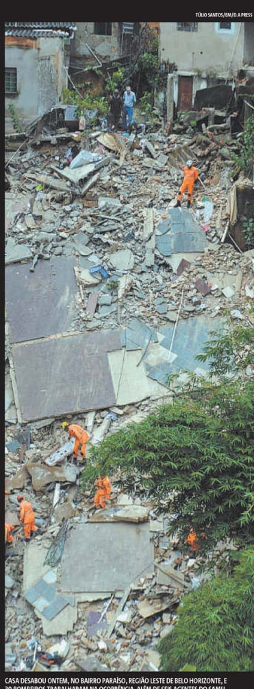
CASA DESABOU ONTEM, NO BAIRRO PARAÍSO, REGIÃO LESTE DE BELO HORIZONTE. E DOIS BOMBEIROS ENCONTRARAM AS VÍTIMAS. A PERÍCIA VAI FAZER A BUSCA DAS INFORMAÇÕES PARA DIZER O QUE REALMENTE PODE TER CAUSADO ESTE DESABAMENTO.
