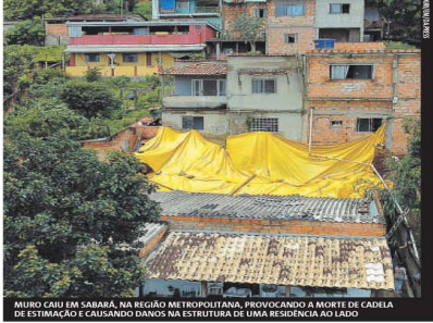
MURO CAIU EM SABARÁ, NA REGIÃO METROPOLITANA, PROVOCANDO A MORTE DE UMA CADELA DE ESTIMAÇÃO E CAUSANDO DANOS NA ESTRUTURA DE UMA RESIDÊNCIA AO LADO
