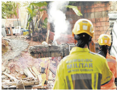
ALÉM DAS OCORRÊNCIAS RELACIONADAS ÀS CHUVAS NA CAPITAL, COMO A CASA QUE DESABOU NA REGIÃO NORDESTE DE BH, BOMBEIROS SE MOBILIZAM NOS ATENDIMENTOS PELO INTERIOR
