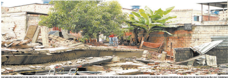
DESAMORAMENTO DE IMÓVEL DE DOIS ANDARES NO BAIRRO SÃO GABRIEL DEIXOU 9 PESSOAS PRESAS DENTRO DE CASA DURANTE QUATRO HORAS DEVIDO AOS RISCOS DE ELETRIFICAÇÃO DO TERRENO
