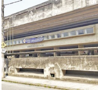
Segundo os técnicos, o prédio está sob severa e perigosa ameaça
