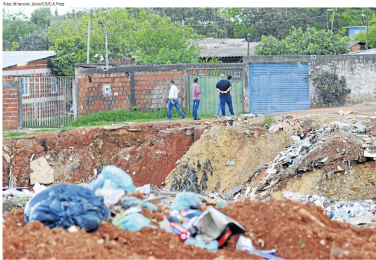
Abertura de uma cratera assustou moradores, ontem, no Trecho 3 do Sol Nascente, em Ceilândia. Um B e GDF monitoram 24 horas as erosões
