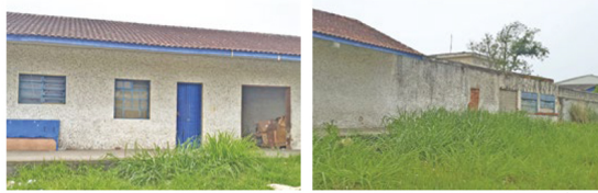
As antigas estações de trem no litoral sul estão em estado de abandono: de Santos a Juquiá eram 34 estações e pontos de parada
