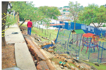
Muro da parte lateral do Centro de Educação Infantil Jardim Encantado caiu durante a tempestade, mas as salas não foram suspensas na unidade; CBJ Zol Valente Belchior e CBJ Perseu Leite de Barros preparam para desmarcar as salas após a aula ficarem alagadas
