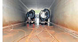
Tesourinha da 102/202 Norte foi interditada para drenagem da água
