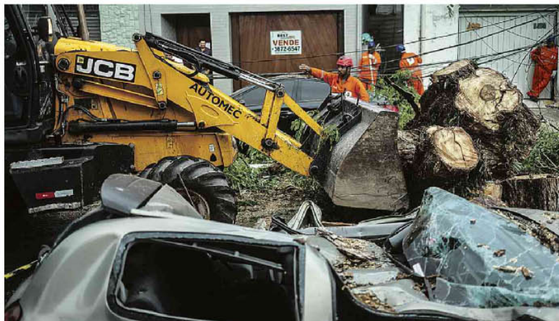
Operários recolhem árvore na rua Catão, na Lapa, após a tempestade que varreu parte da capital na noite de sexta (11) Felipe Inuati/Folhapress
