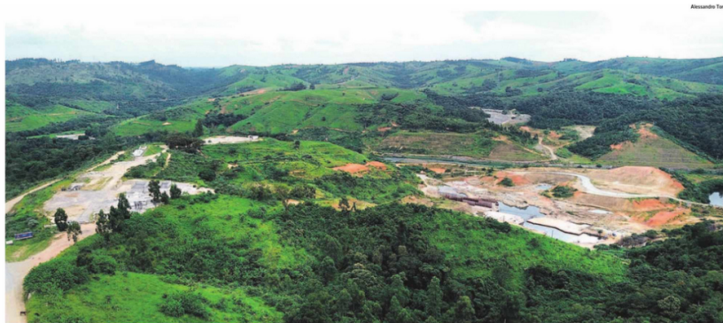
A proposta vencedora da concorrência para a barragem de Pedreira foi de R$ 474,9 milhões, enquanto o custo estimado era de R$ 584,3 milhões; ela terá uma capacidade de armazenamento de 32 bilhões de litros de água e está sendo construída no Rio Jaguari, próximo ao limite com Campinas
