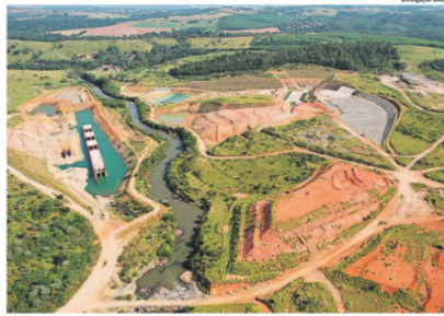
Menos da metade das obras da barragem de Amparo foi concluída; expectativa é que, juntas, as duas barragens formem reservatórios com capacidade de armazenamento útil de 85 bilhões de litros de água
