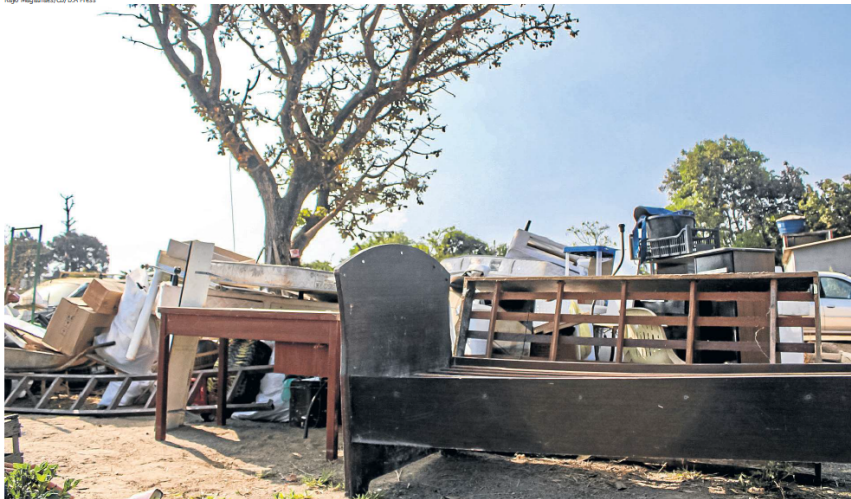
Dois casas do assentamento 26 de setembro foram demolidas na semana passada porque o local foi apontado como foco de desmatamento
