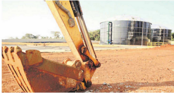
No Parque das Universidades, em Campinas, estão sendo construídos reservatórios capazes de armazenar seis milhões de litros de água; esses projetos, financiados pela Sanasa, resultaram na criação de pelo menos 50 mil empregos diretos, indiretos e induzidos
