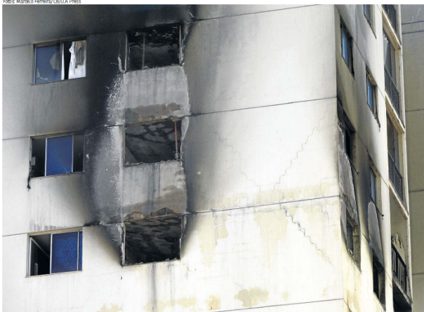
Polícia também suspeita de que trabalho feito em sofá possa ter provocado explosão. Vazamento de gás não foi descartado
