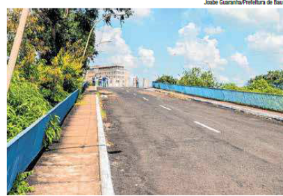
Viaduto João Simonetti em Bauru; alça de acesso está interditada
