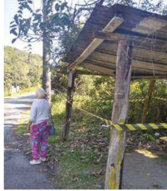
Pontos de ônibus em situação precária na Estrada Guarujá-Bertioga
