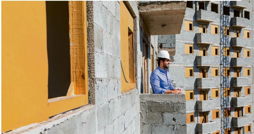
Sem gente. Guilherme Yogolare, CEO da Vinx, está com 80 vagas abertas nas doze obras que a construtora tem em andamento: "Faltam encanadores, eletricitas, bloqueiros, serventes, carpinteiros"
