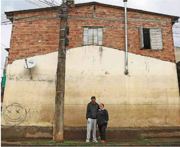
Local onde Adriano e Fernanda moram, na Capital, teve estrutura comprometida pela inundação
