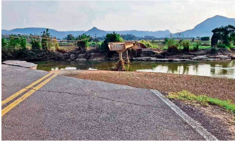
Na RS-348, estrutura sobre o Rio Soturno, próximo a Faxinal do Soturno, na Região Central, acabou destruída durante a tragédia climática
