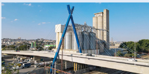
Ao todo foram investidos R$ 53,6 milhões na obra iniciada em 2022 e que promete ser um marco arquitetônico, além de melhorar a fluidez na região
