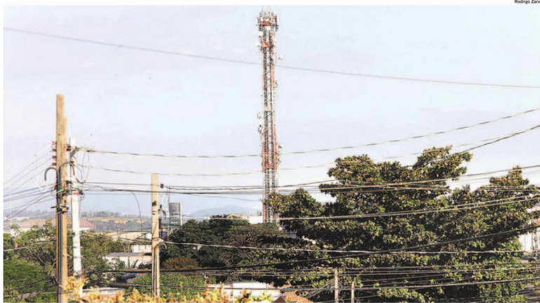
De acordo com a Conexis Brasil Digital, entidade que reúne empresas de telecomunicações e conectividade, são necessárias de 5 a 10 vezes mais antenas 5G do que 4G para cobrir a mesma área; no ciclo de 2023 a 2025, as empresas do setor preveem investir US$ 250 milhões (R$ 1,39 bilhão) na expansão da rede no Brasil
