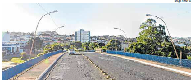
Alça de acesso do viaduto à Nuno de Assis foi interditada por problemas estruturais
