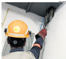
PERIGO. 'Gatos' podem gerar curtos-circuitos, sobrecargas e incêndios
