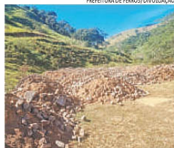
FOTO FORNECIDA PELO PREFEITURA MOSTRA AS PEDRAS RETIRADAS DA RUA DO ROSÁRIO EM TERRENO DESCAMPADO
