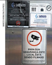
PLACA INDICA A CAPACIDADE MÁXIMA DO ELEVADOR: 17 PESSOAS. NA HORA DO ACIDENTE, CABINE LEVAVA 22
