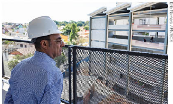
Cerca de 70% da obra idealizada pela Gestão Auricchio já foi concluída e segue para a fase de acabamento
