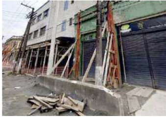
Dezenas de casas estão escoradas, com as fachadas caindo por conta do mau planejamento da obra do Estado
