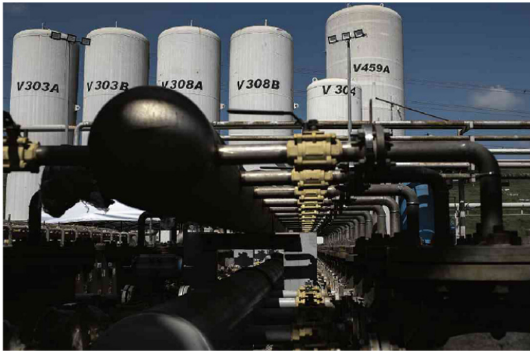
Instalações da Gás Verde, do Grupo Urca, em Seropédica (RJ); unidade de refino de biogás em biometano é a maior da América Latina
