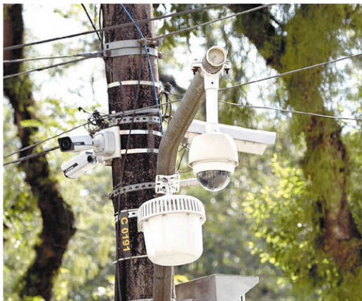
As câmeras serão do tipo fixo e PTZ, que se movimenta na horizontal e vertical e permite aproximar a imagem
