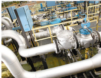
Dutos de gás: empresas que compram produto sem passar pelas distribuidoras também serão beneficiadas
