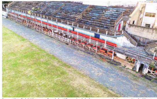
Espaço está interditado há 15 meses; arquibancada do estádio corre risco de desabar e preocupa a população que aproveitou o local durante anos
