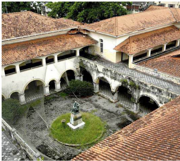
O conjunto arquitetônico na Praia da Aparecida é tombado por diversos órgãos, mas está abandonado, tomado pelo mato e em ruínas
