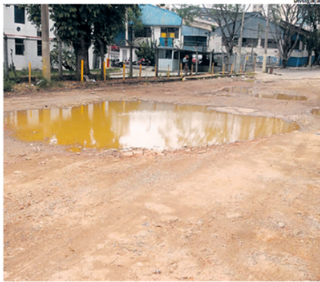
PROBLEMA. Água acumula no meio da Rua Tapajós em dia de chuva
