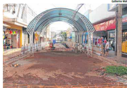
Somente três funcionários trabalham no local; comerciantes afirmam que há alguns dias só havia dois na obra
