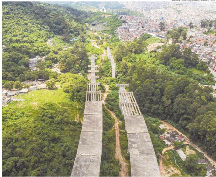
Construção foi suspensa em 2018. Com a retomada seis meses antes do previsto, a entrega é aguardada para o segundo semestre de 2026
