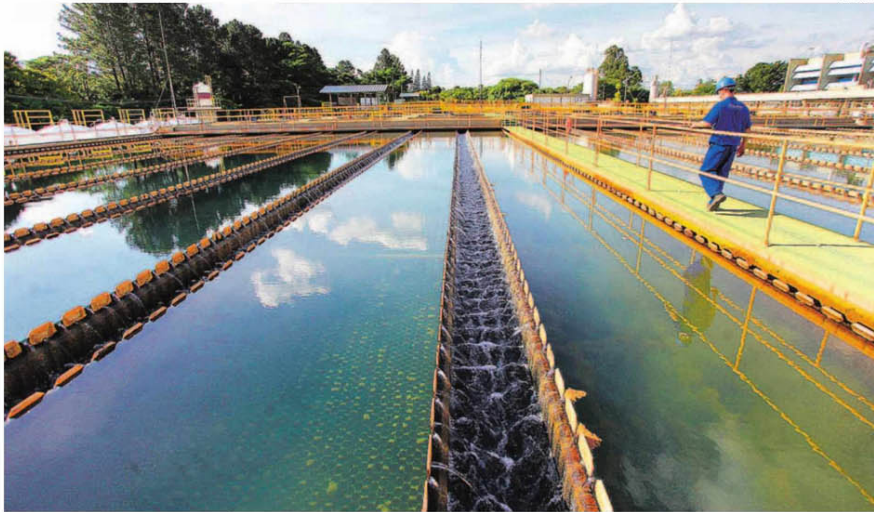
Estação de Tratamento de Água 4 da Sanasa, localizada no distrito de Sousas: empresa tem feito diversos investimentos em obras que integram o Plano Campinas 2030, criado para aprimorar e garantir a segurança hídrica de Campinas e o desenvolvimento sustentável
