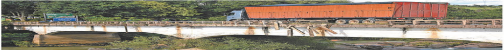
TRUCK SOBRE O PONTE GRÁVE E ESTRADA COM VÁRIOS BURACOS EM UM TRECHO CRÍTICO. O RISCO DE ACIDENTES É GRANDE POR CAUSAS COMO A FALTA DE SINALIZAÇÃO E O MATO ALTO, QUE AGRAVA OS PERIGOS DA ESTRADA.
