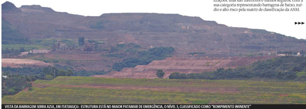
VISTA DA BARRAGEM SERRA AZUL, EM ITATIAIÇU: ESTRUTURA ESTÁ NO MAIOR PATAMAR DE EMERGÊNCIA, O NÍVEL 3, CLASSIFICADO COMO “ROMPIMENTO IMINENTE”
