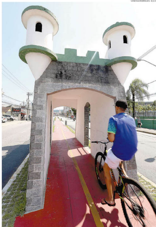
Obras na Avenida Antônio Emmerich, em São Vicente, devem terminar neste mês, conforme Administração
