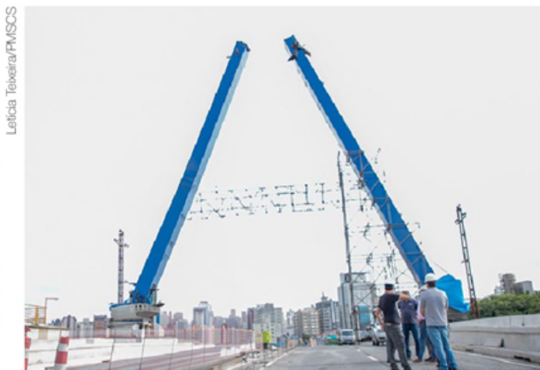
Trabalhadores continuam executando as obras na principal ligação entre São Caetano e Capital
