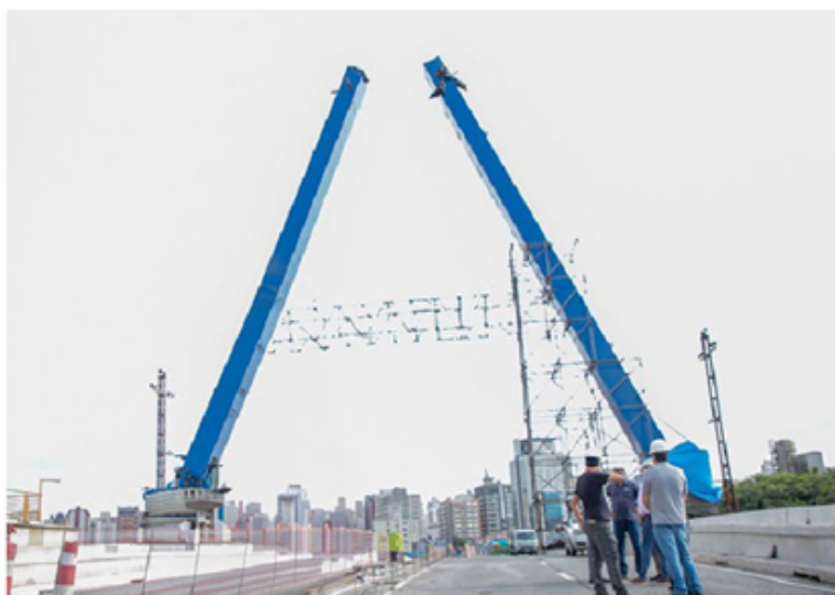
Trabalhadores continuam executando as obras na principal ligação entre São Caetano e Capital
