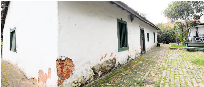
MUSEU DE MAUÁ. Equipamento apresenta problemas estruturais e funcionários reclamam de ausência de melhorias há tempos
