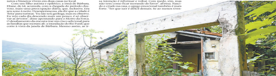
CASA DESOCUPADA NO BARRIO TAQUARAL, UM DOS MAIS ATINGIDOS POR DESLIZAMENTOS NOS PERÍODOS CHUVOSOS E QUE JÁ CHEGOU A SER CONSIDERADO “PERDIDO”
