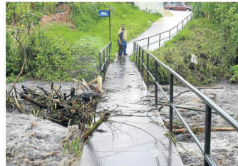
Na Vila Cauhy, a chuva ameaçou ponte no córrego Riacho Fundo
