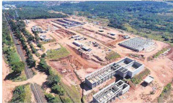
Estação de Tratamento de Esgoto Vargem Limpa, obra iniciada em 2015 e paralisada em 2021, segue inacabada; perícia não deve ser concluída antes da metade deste ano
