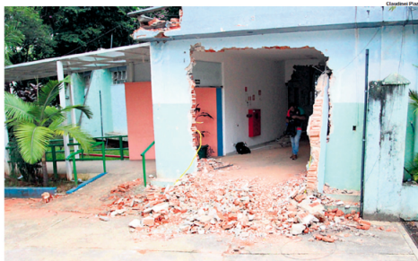
ANNE SULLIVAN. Prédio já está sendo demolido para dar lugar a complexo de saúde para pessoas com deficiência
