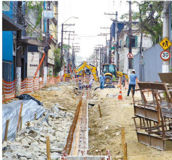
Rua da Constituição, por onde passará o VLT, terá um novo trecho interditado a partir de quarta-feira
