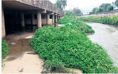
ALERTA. Piscinão de Santo André precisa de roçagem e desassoreamento; galerias também estão sujas
