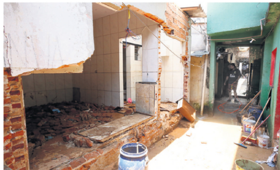
NO CHÃO. Paredes não resistiram à força da água e acabaram caindo, gerando danos nas residências
